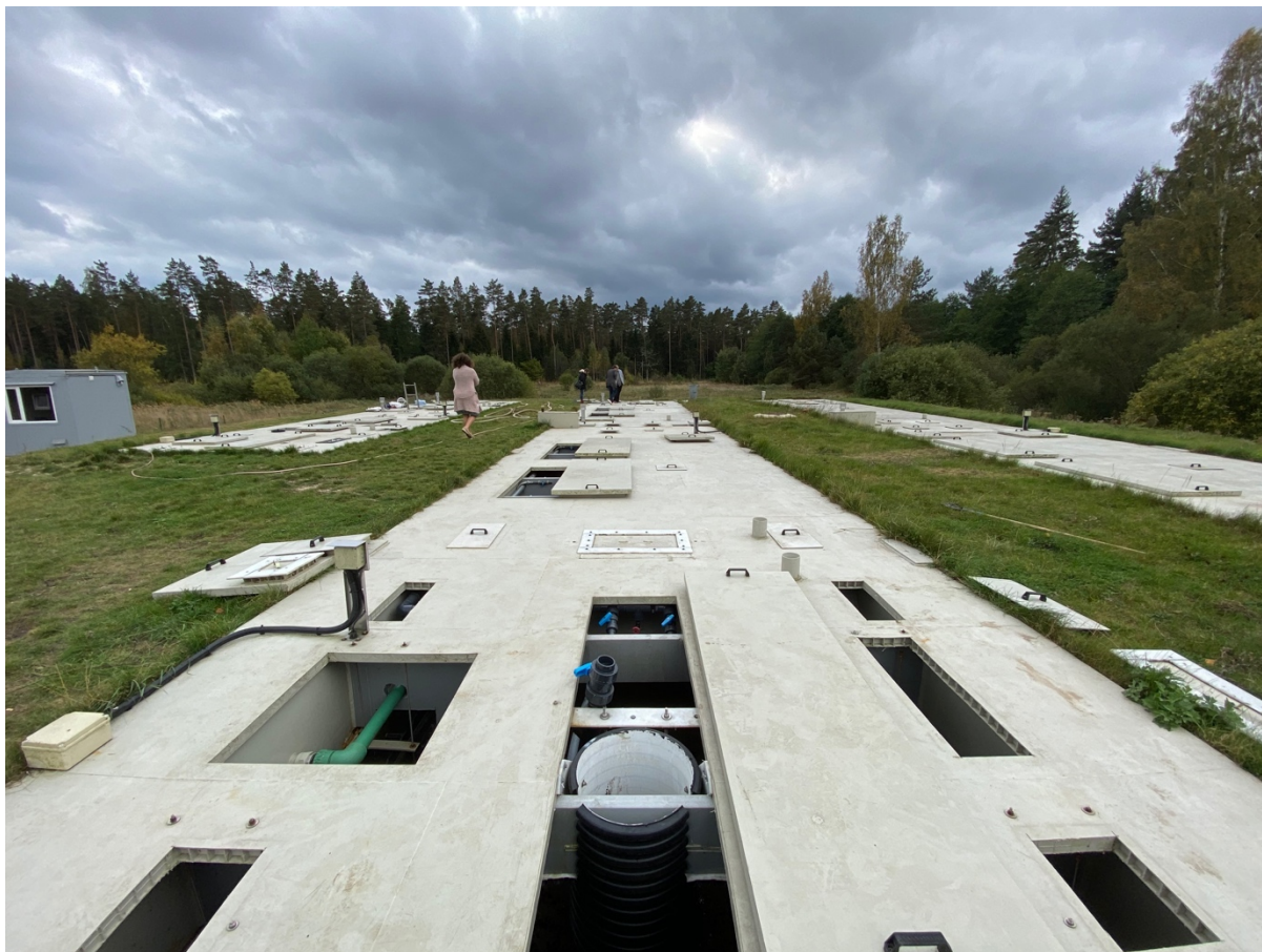
Attēls Nr. 6. Engures ciema bioloģiskās notekūdeņu attīrīšanas iekārtas BIO M (attēls uzņemts 2020. gada oktobrī, veicot Engures NAI apsekošanu klātienē)
