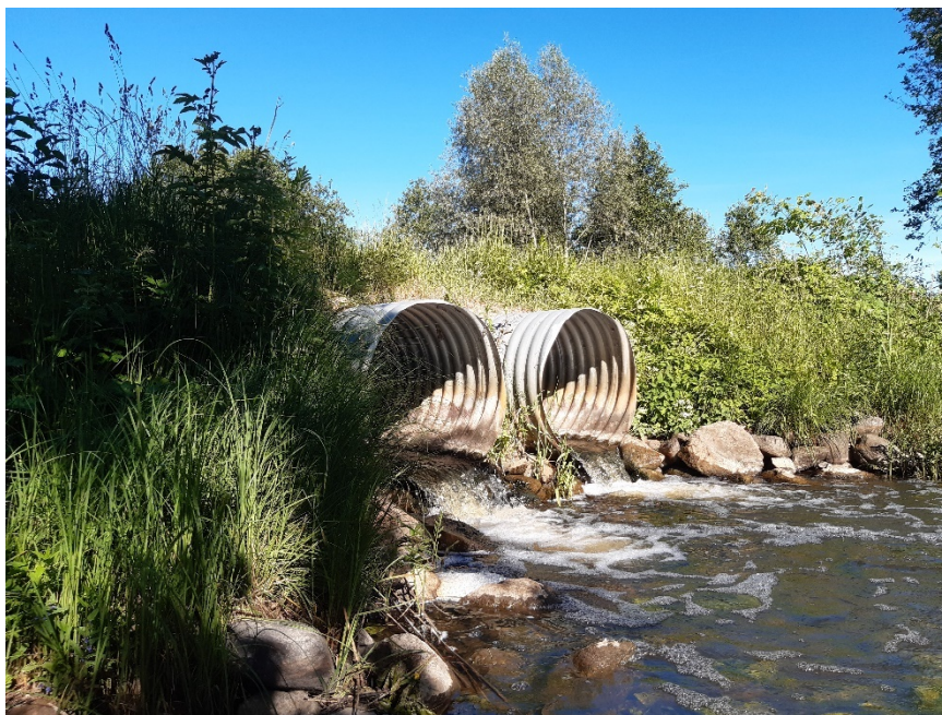
3.2. attēls. Nepareizi iebūvēta vietējas nozīmes autoceļa caurteka augšpus Bēnes HES
