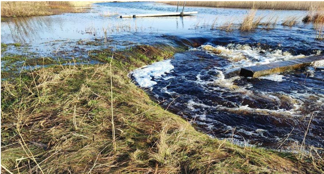
4.4.attēls. 2019-2020. gadā izbūvētā pārgāzne un zivju ceļš, krasta erozija ūdensnotekas labajā krastā
