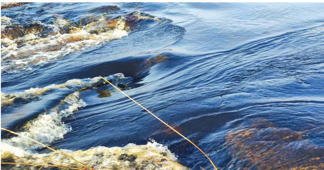
4.5.attēls. Papes kanāla pārgāznes zivju ceļa izzāgētās ailas – deformēts U veida tērauda profils
